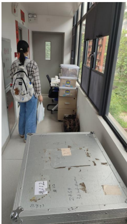
5. 农学 38-303 消防通道堵塞
